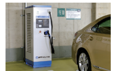
急速EV充電器
